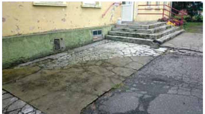
Żabowo - droga i schody przed remontem
